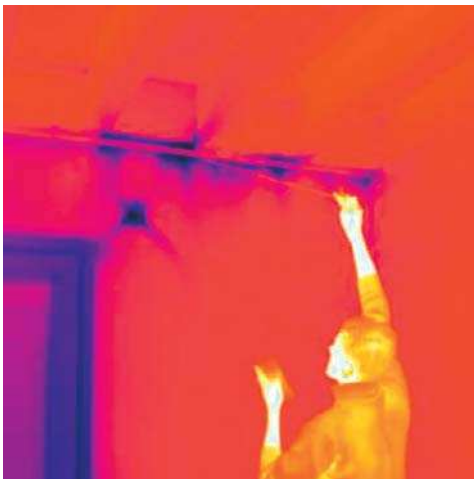
Estructural. Esto es un fallo de diseño, de fabricación o de construcción. La reparación, una vez la construcción se ha finalizado, es prácticamente imposible.
