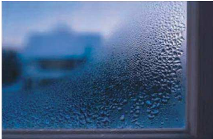
Fotografía 5. Condensaciones en el interior de las viviendas.
