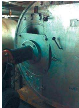
Figura 2. Caldera con junta deteriorada.
